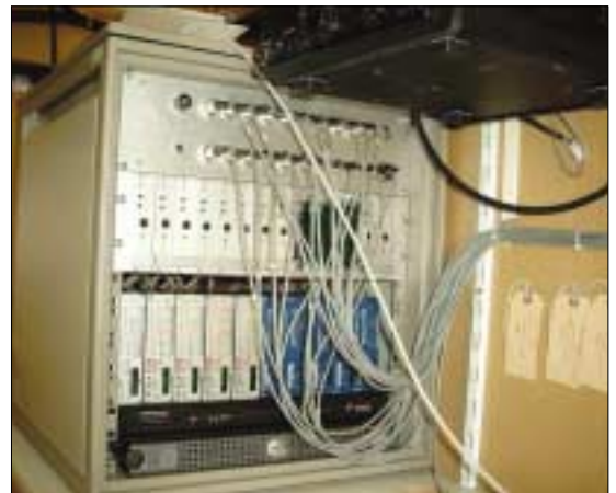
Bild 7. Steuerschrank des Senders von Kiel Radio. Unten sichtbar: der Server und zehn Pactor-Modems. (Foto: Kiel Radio)
